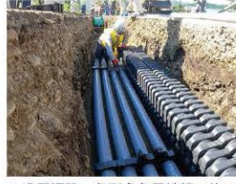
▲浅層埋設、角形多条電線管の施工 (国道5号 赤松街道電線共同溝)
