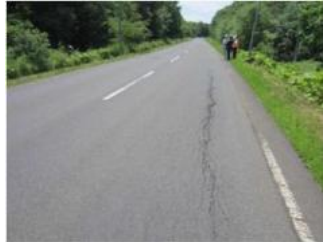
適用路線の損傷状況
