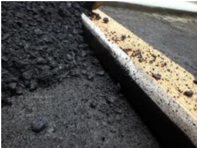
型枠側に集まる粗骨材
