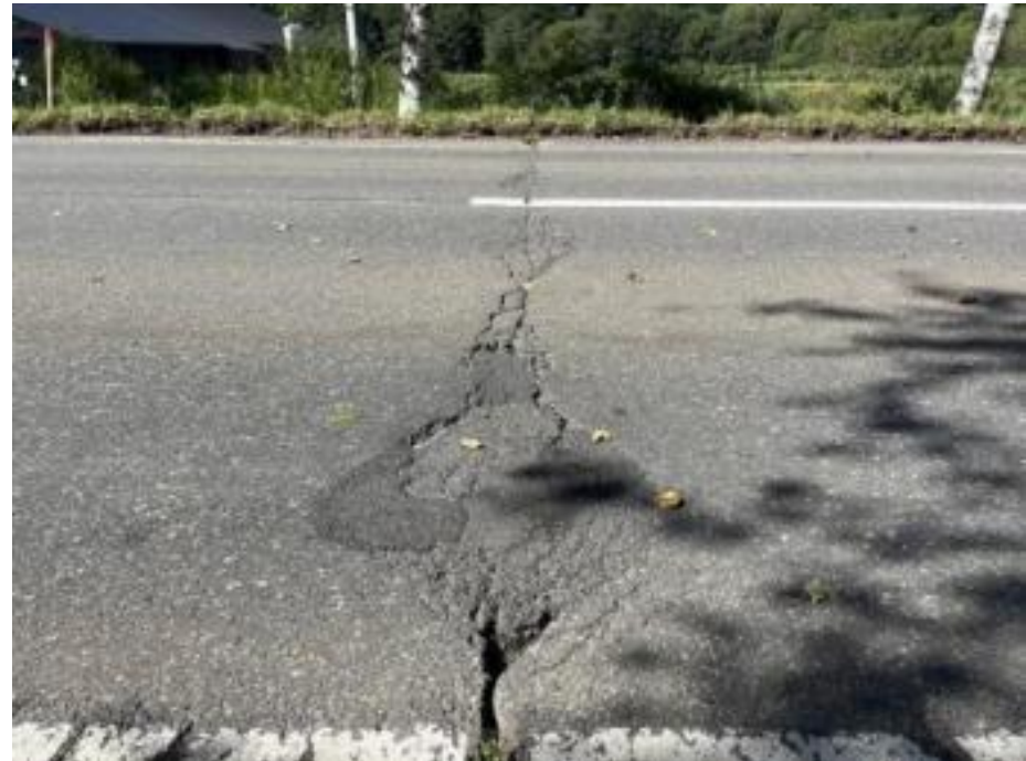
輪跡部が亀甲状ひび割れとなり、 ポットホールに進行 →パッチングで補修
