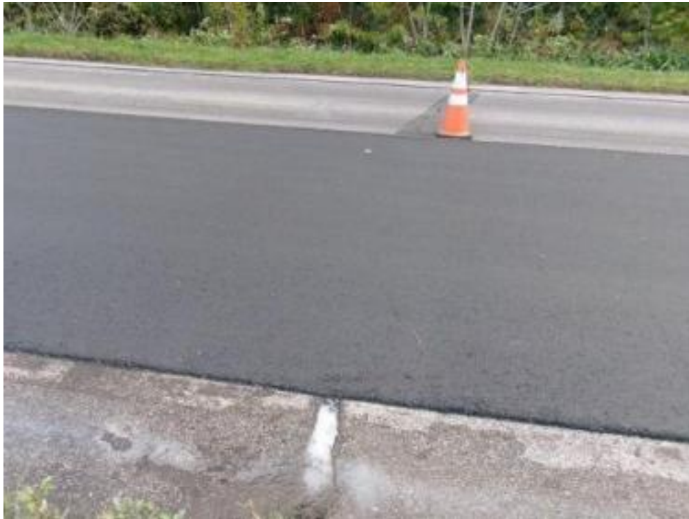
横断クラック上のシナヤカファルト （起点から5m付近）
