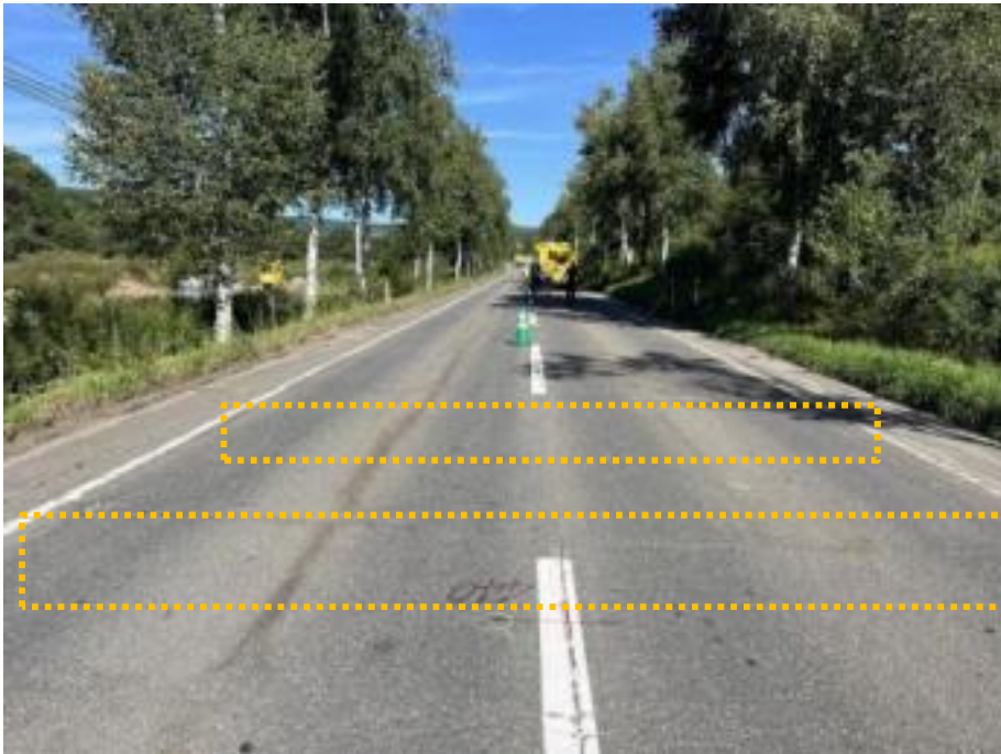
約5m間隔で横ひび割れ (ひび割れの原因は温度ひびわれ)
