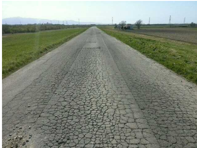
亀甲状の亀裂
