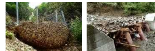
(参考) ワイヤネットやスリットダムによる土石や流木の捕捉
