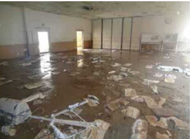
高齢者関係施設の被災状況(岡山県倉敷市)※3
