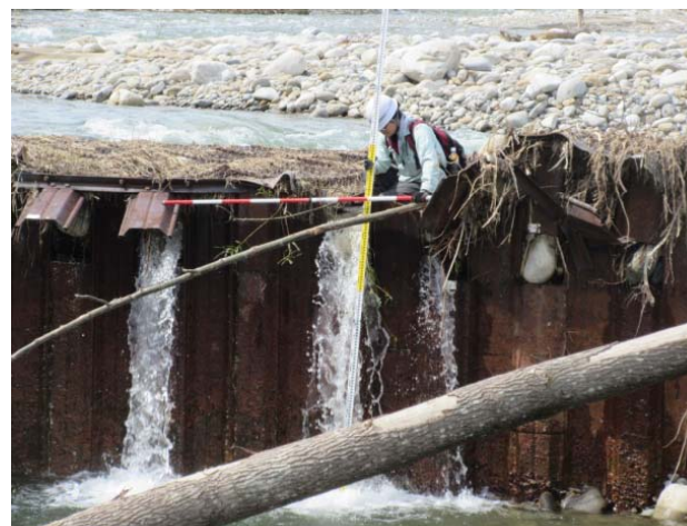
被災施設の調査状況
