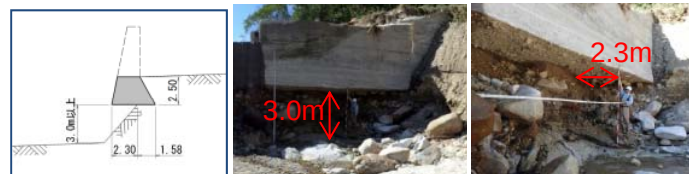
【左岸端部 被災状況】
