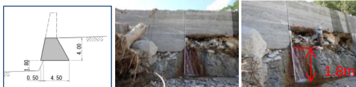
【左岸中央部 被災状況】
