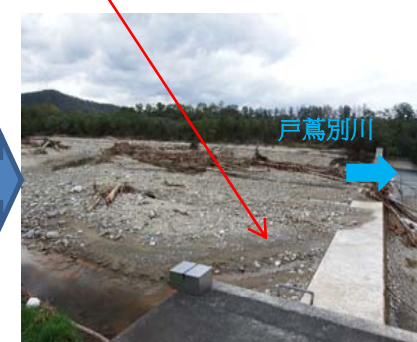
被災後の戸蔭別川第1号砂防堰堤 (H28.9撮影)
