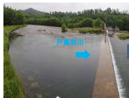
被災前の戸蔭別川第1号砂防堰堤 (H26.7撮影)
