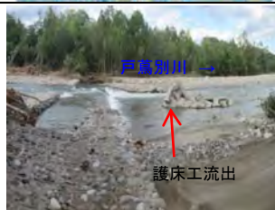
戸蔭別川第2号床固工の被災状況(平成28年撮影)
