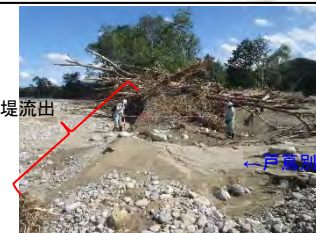
第4号床固工左岸導流堤の被災状況(平成28年撮影)
