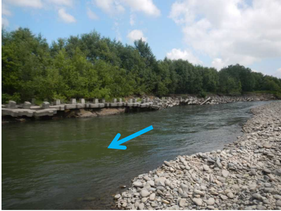
図 1.7 浮き上がった状態の低水路護岸
