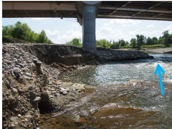
図 1.9 橋脚付近における急激な河床低下
