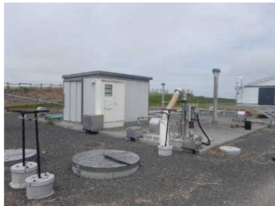
写真：調整槽 (令和3年6月撮影)
