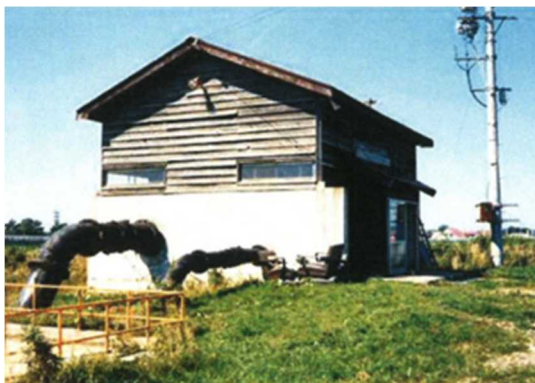
東裏揚水機（改修前） (札幌開発建設部)
