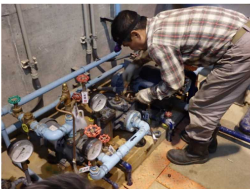
写真：茂平沢揚水機設備点検 (当別土地改良区からの提供)
