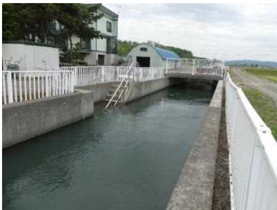
写真：用水路に整備された生活用水施設 (令和5年6月撮影)
