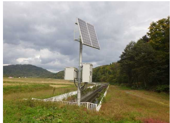
写真：水位データ転送装置 (令和5年10月撮影)
