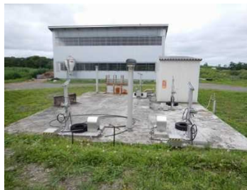
写真：流入口・調整槽
