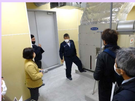
非常用電源施設
