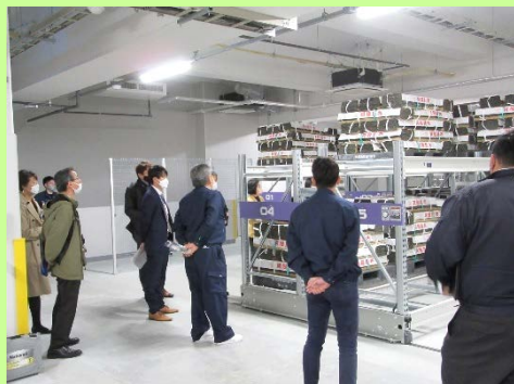
空調管理倉庫
