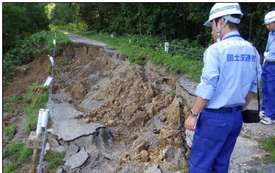
被災状況調査（8/25 名寄市 御料十二線橋）
