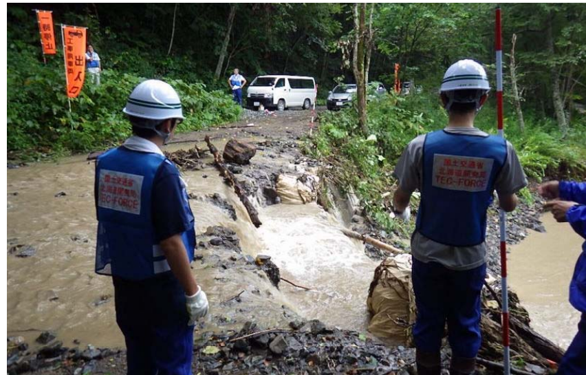
被災状況調査（8/26 占冠村 村道1号）
