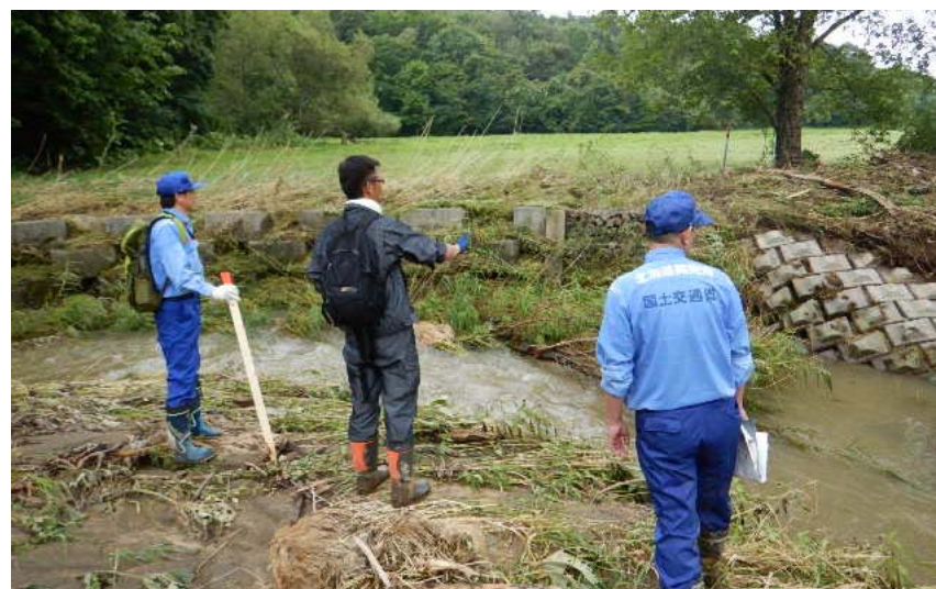
被災状況調査（8/26 新冠町 元神部左の沢川）
