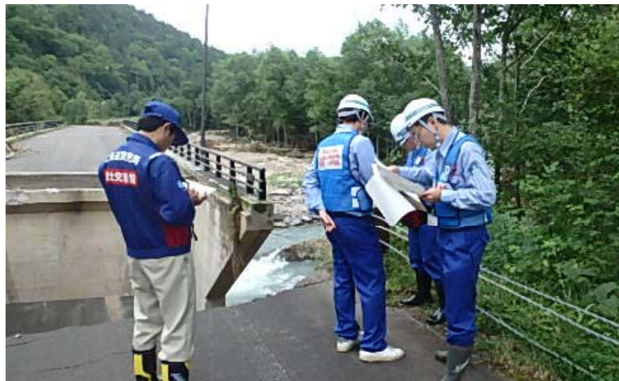
被災状況調査（8/26 美瑛町 町道白金美瑛支線水楽橋）
