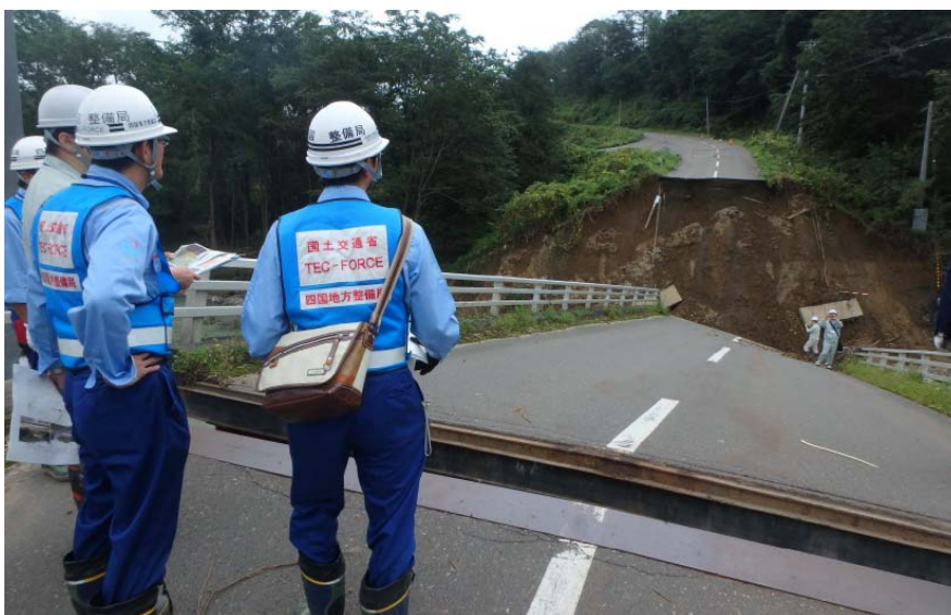
四国地整道路班 帯広市 明星橋（岩内川）被災調査
