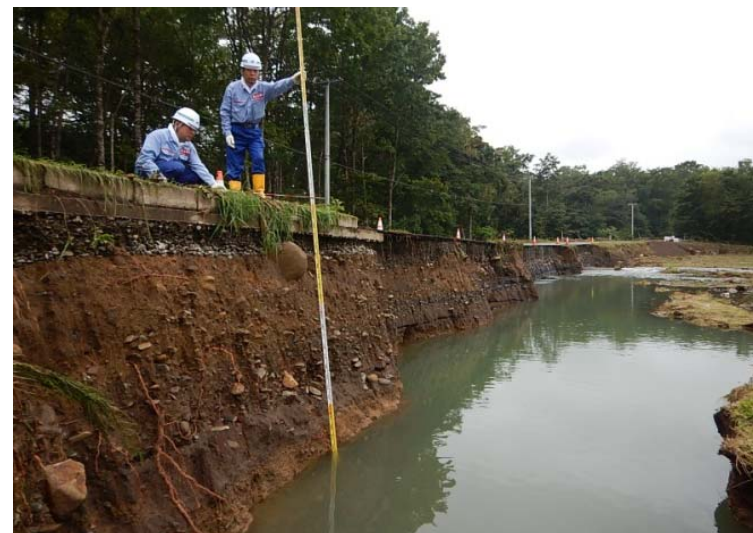
小樽開建道路班 芽室町 町道の冠水箇所調査
