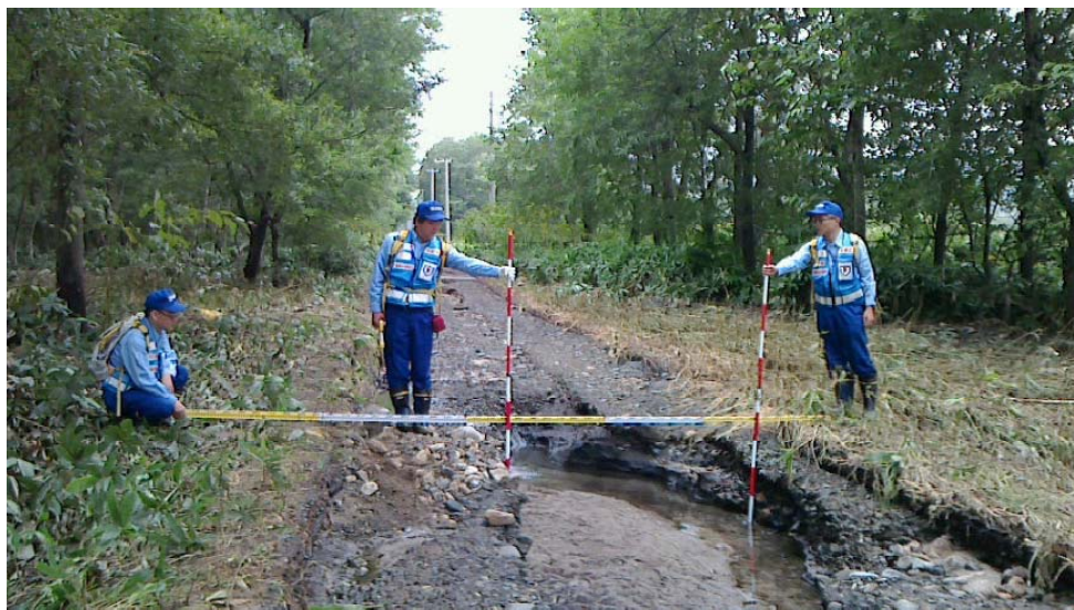
四国地整河川班 清水町 久山川沿い町道被災状況調査
