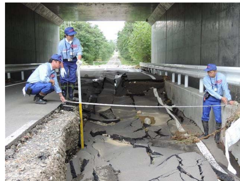
網走開建道路班 清水町 町道（道東道アンダーパス）被災状況調査
