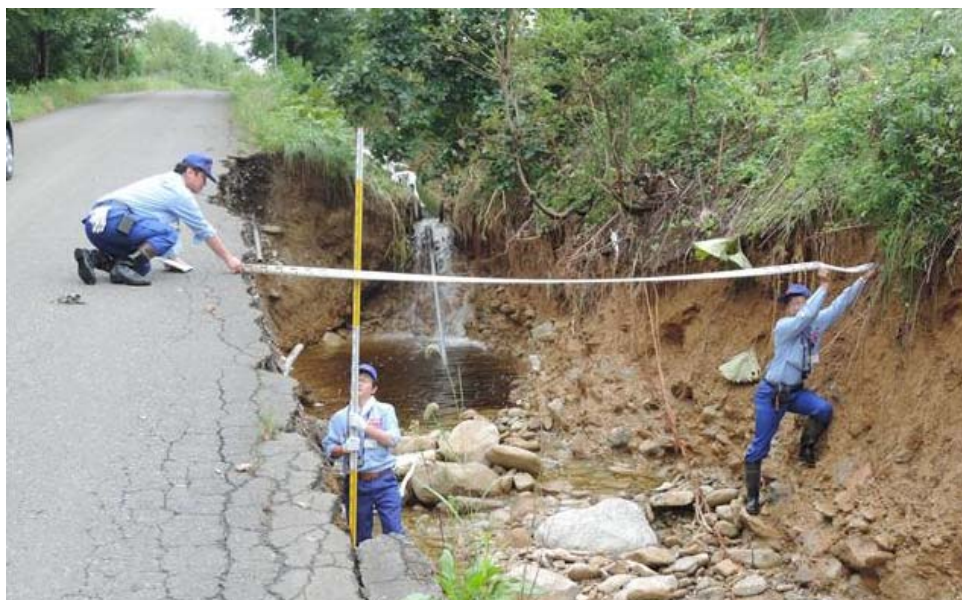
網走開建道路班 清水町 町道洗掘箇所調査
