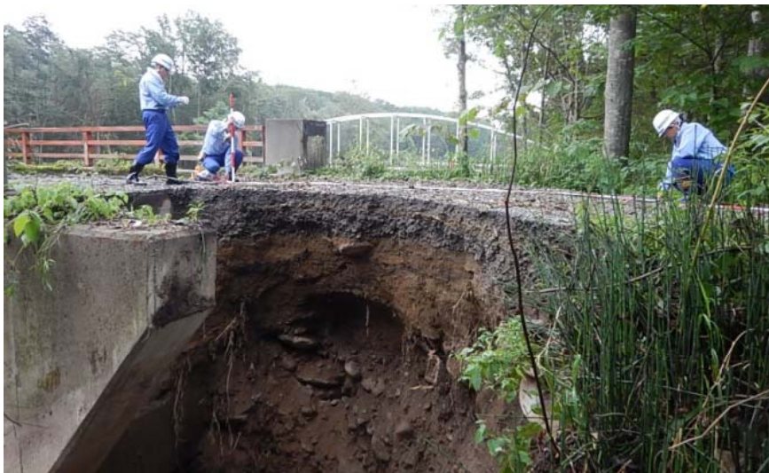
小樽開建道路班 芽室町 西伏美橋被災調査
