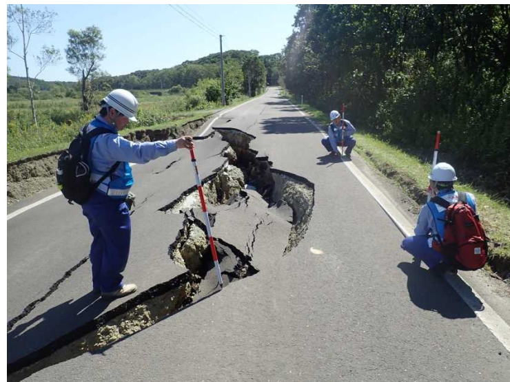
道路被災状況調査（安平町）（北陸地整）
