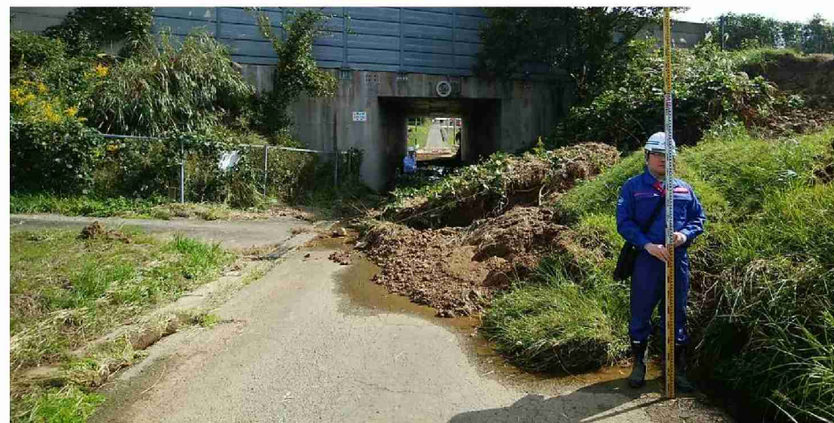
被災状況調査 (福島県大玉村)
