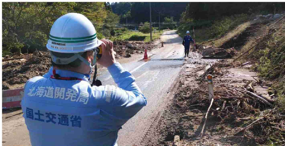
被災状況調査(福島県伊達市)
