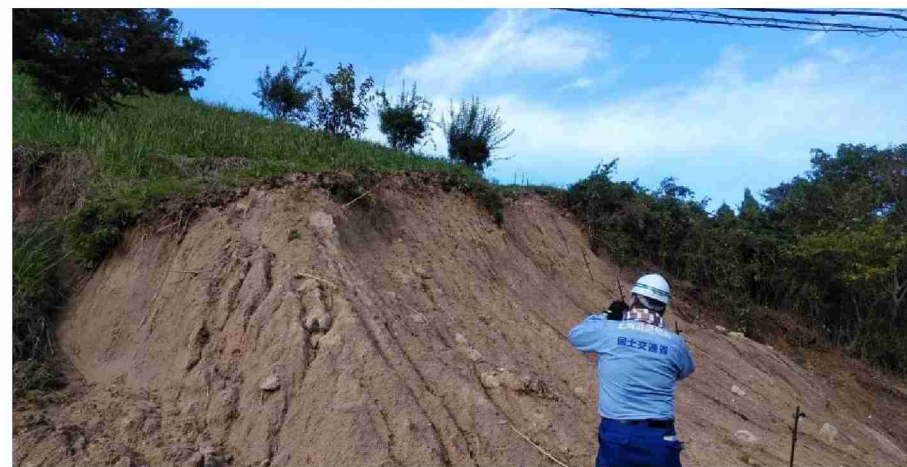
被災状況調査(福島県伊達市)
