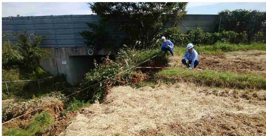
被災状況調査 (福島県大玉村)
