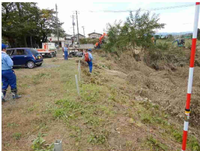
被災状況調査(河川被災箇所) (郡山市安積町古川池地先)
