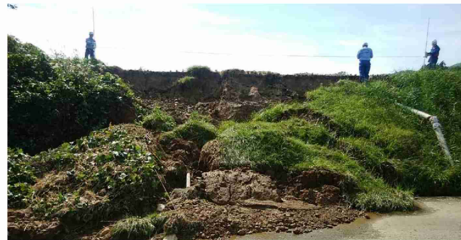
被災状況調査 (福島県大玉村)
