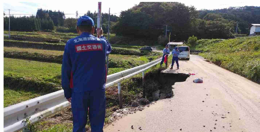
被災状況調査 (宮城県丸森町筆甫地区)
