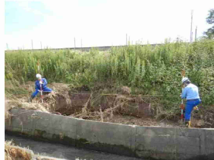
被災状況調査(河川被害箇所) (福島県須賀川市・古戸川右岸洗掘)
