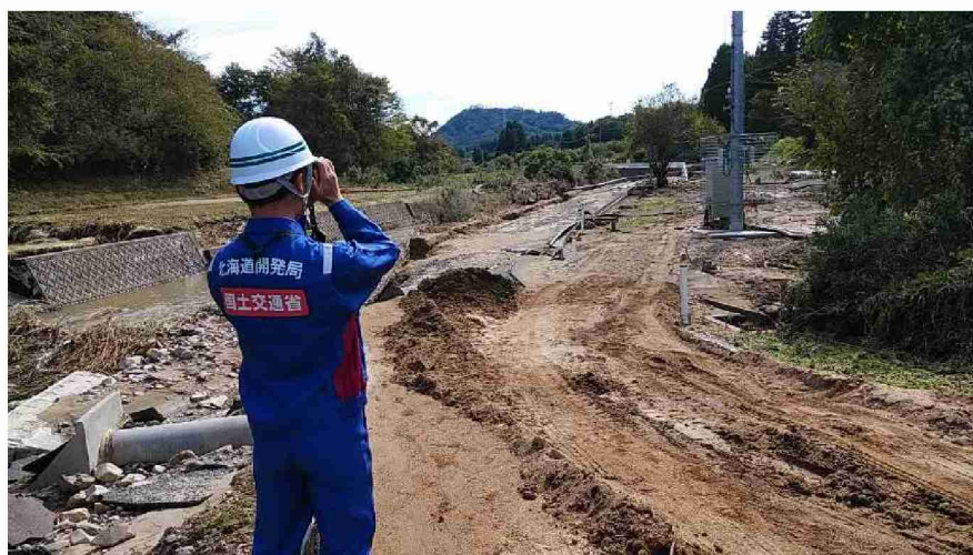
被災状況調査(道路被災箇所) (宮城県丸森町東福田周辺 奈良又川)
