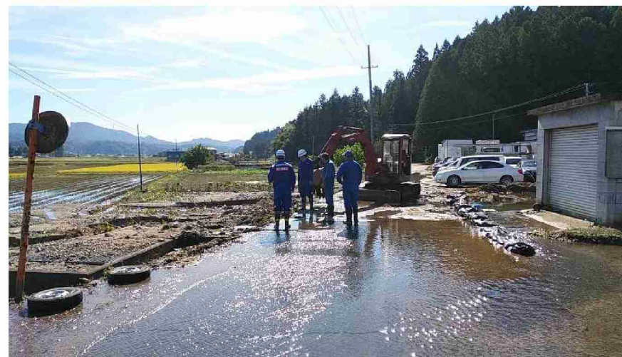
被災状況調査(道路被災箇所) (宮城県丸森町町道5101線)
