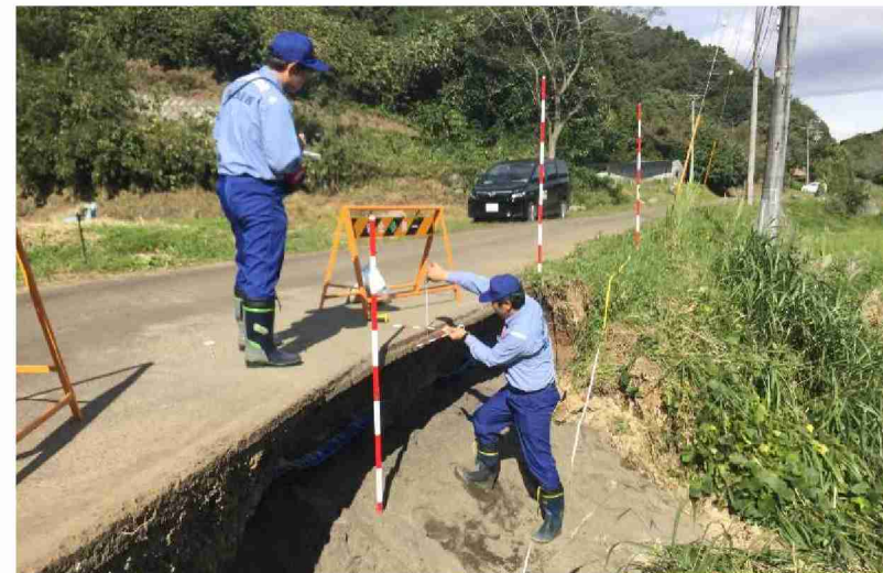
被災状況調査 (宮城県村田町)
