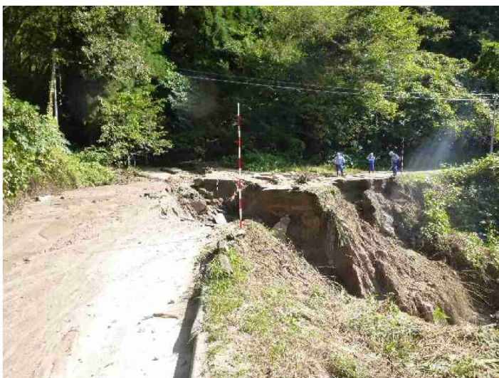
被災状況調査(道路被災箇所) (福島県川俣町 長滝線道路寸断)
