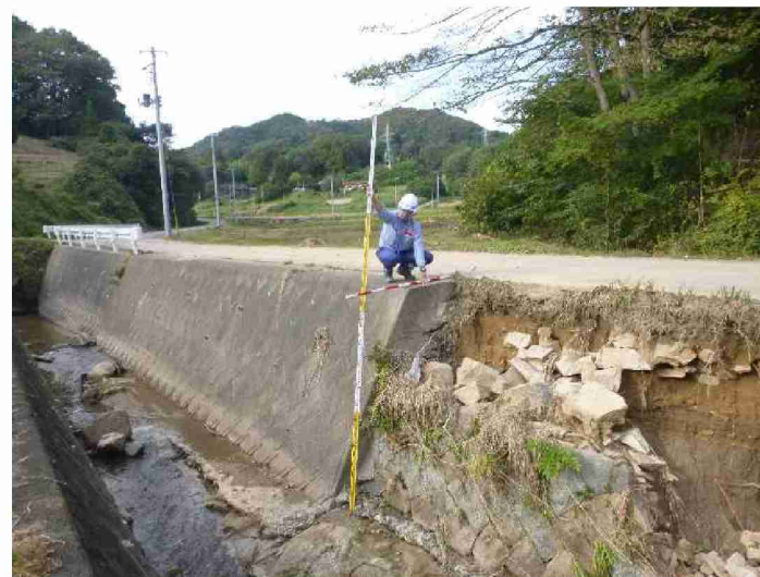
被災状況調査(道路被災箇所) (福島県川俣町・芦沼田線護岸崩れ)
