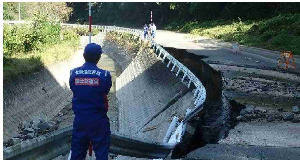
被災状況調査 (伊達市山舟生地区 大小川)
