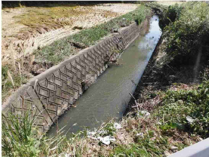
被災状況調査(河川被害箇所) (福島県須賀川市・岩下川)
