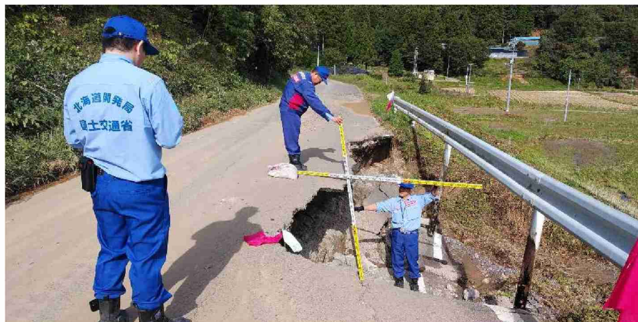
被災状況調査 (宮城県丸森町筆甫地区)
