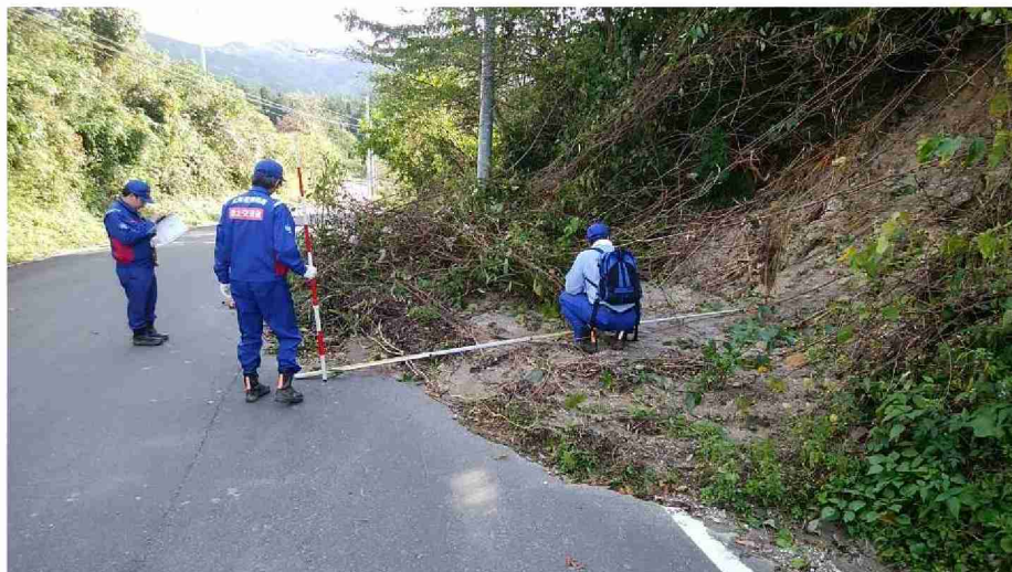
被災状況調査 (宮城県丸森町)
