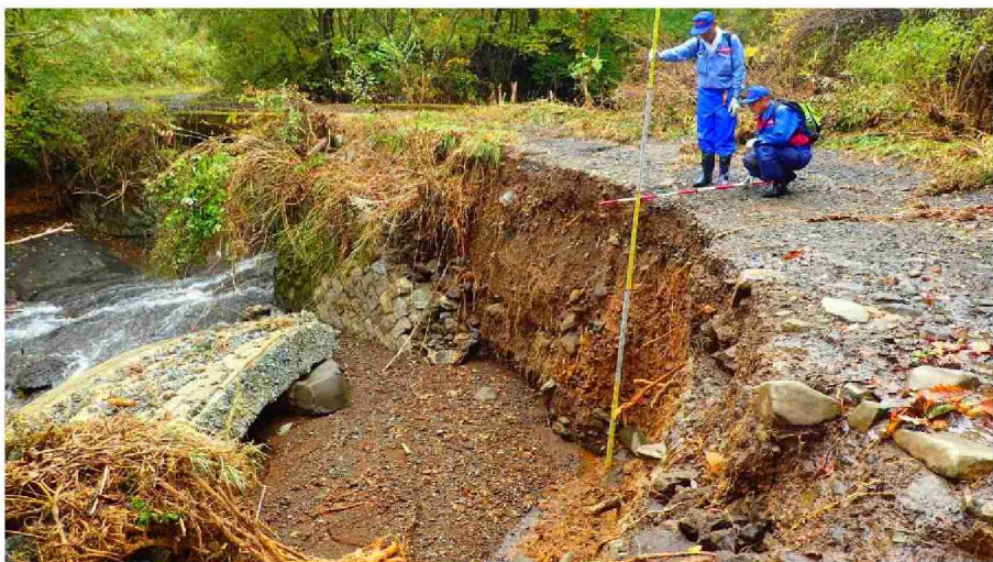
被災状況調査 (宮城県丸森町)
