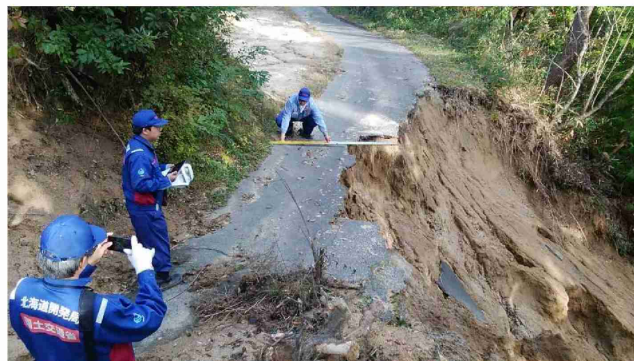
被災状況調査状況 (宮城県丸森町)
