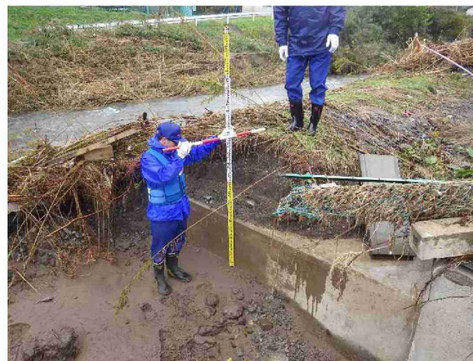
被災状況調査 (宮城県丸森町)
