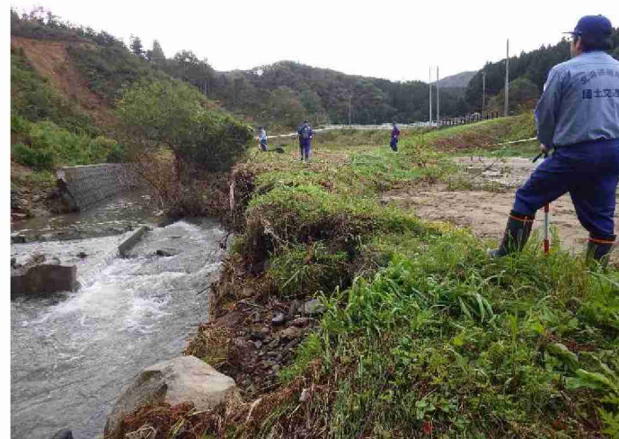
被災状況調査 (宮城県丸森町)
