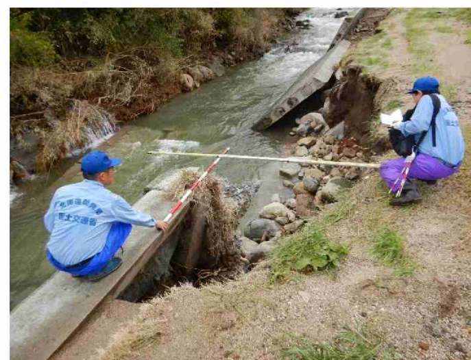
被災状況調査 (宮城県丸森町)
