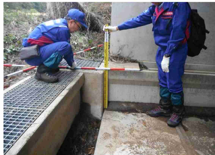
被災状況調査 (福島県相馬市)
