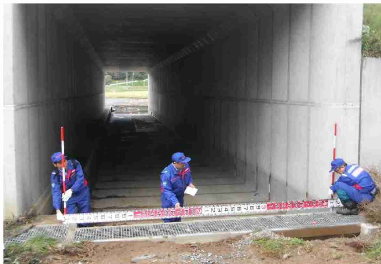
被災状況調査 (福島県相馬市)
