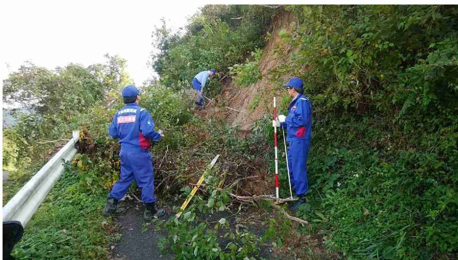
被災状況調査 (宮城県丸森町)
