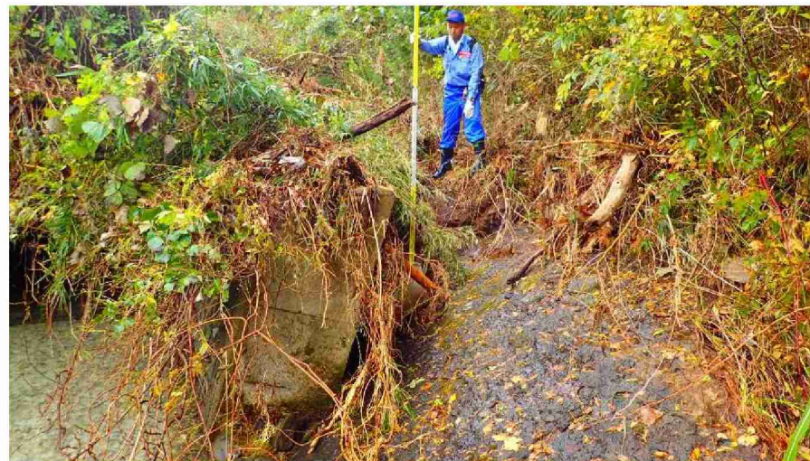
被災状況調査 (宮城県丸森町)
