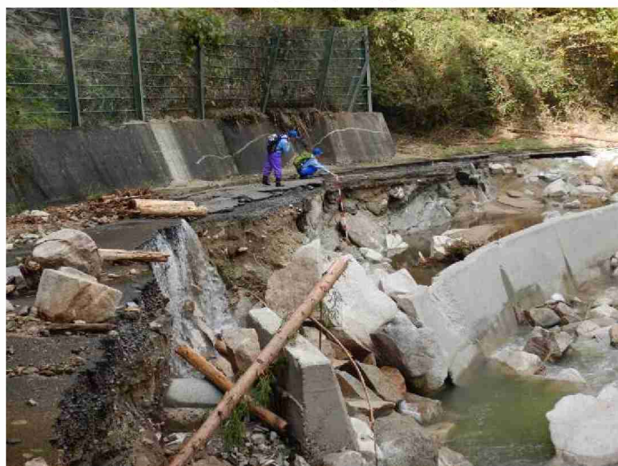
被災状況調査 (宮城県丸森町)
