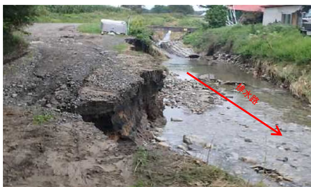
排水路の被災(清水町)
