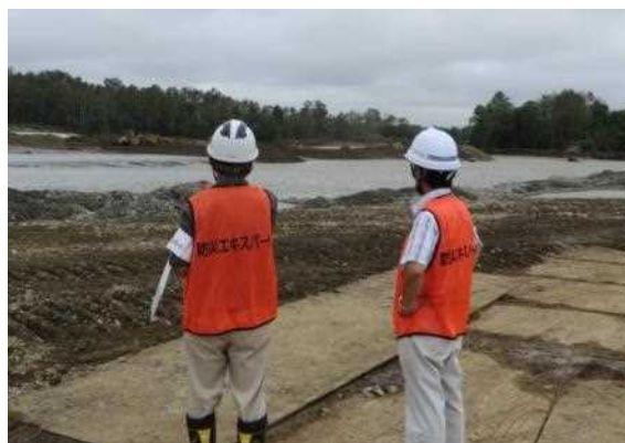
決壊箇所の調査 戸鳶別川 9月2日
