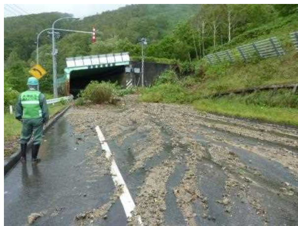
被災箇所調査 国道38号狩勝峠 8月31日
