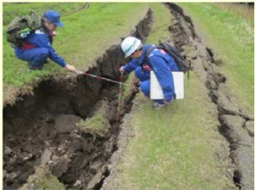
河川の被災状況調査 堤防天端亀裂
