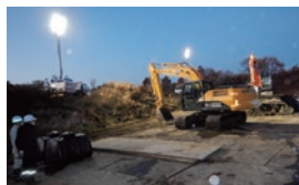
災害対策用機械(照明車)の派遣(伊達市)
