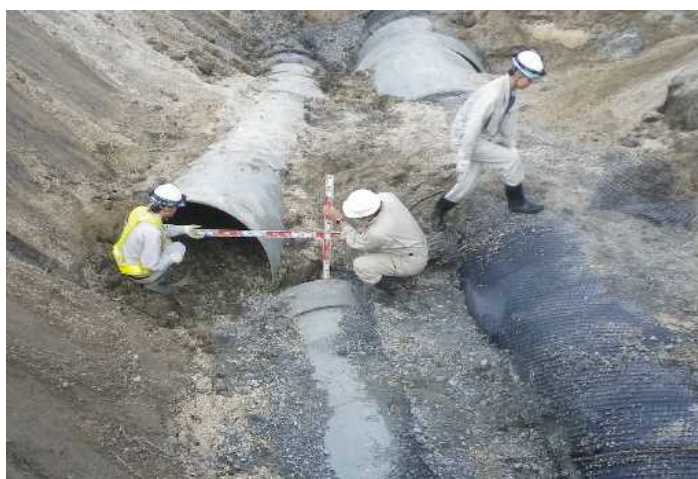
管の離脱状況(H30)
