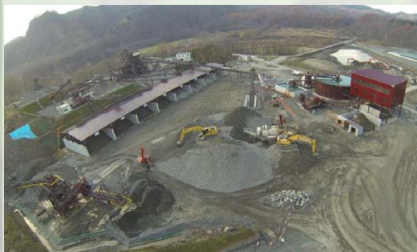
骨材製造設備
