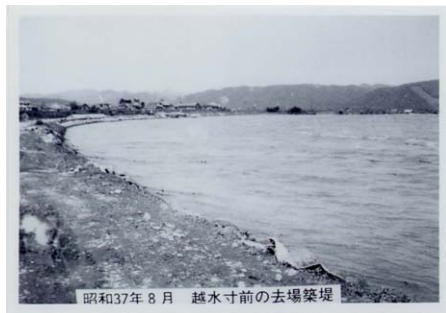
越水寸前の去場築堤
