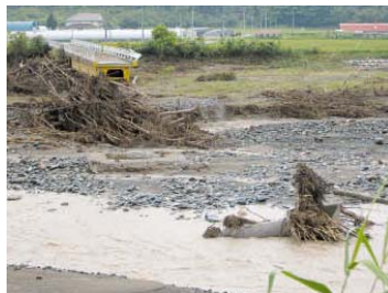
沙流川上流の被害 (流木により流出した橋梁)
