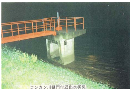
コンカン川樋門付近出水状況
