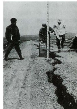
豊城地区堤防天端の亀裂
