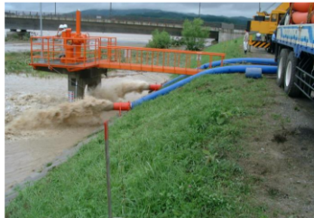
ポンプ排水状況(穂別1号樋門、平成15年8月洪水)
