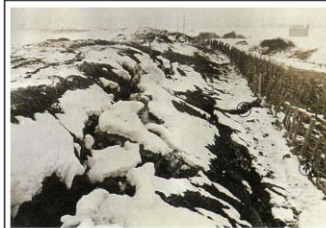
豊城築堤の亀裂
