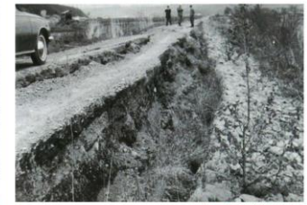
写真 1-21 豊城築堤 堤防のすべり破壊 (昭和43年(1968年)十勝沖地震)
