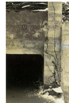
写真 1-22 豊城樋門の亀裂 (昭和27年(1952年)十勝沖地震)
