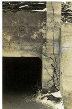
豊城樋門の亀裂
