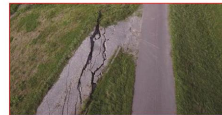
写真 1-24 河口左岸築堤の亀裂 (平成 30 年(2018 年)北海道胆振東部地震)
