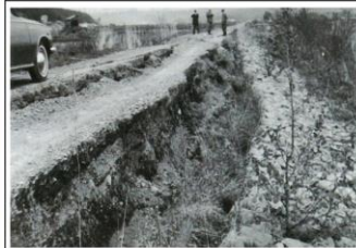
豊城築堤 堤防のすべり破壊
