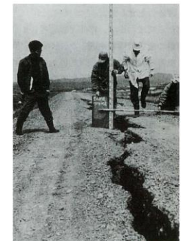
写真 1-23 豊城地区堤防天端の亀裂 (昭和43年(1968年)十勝沖地震)
