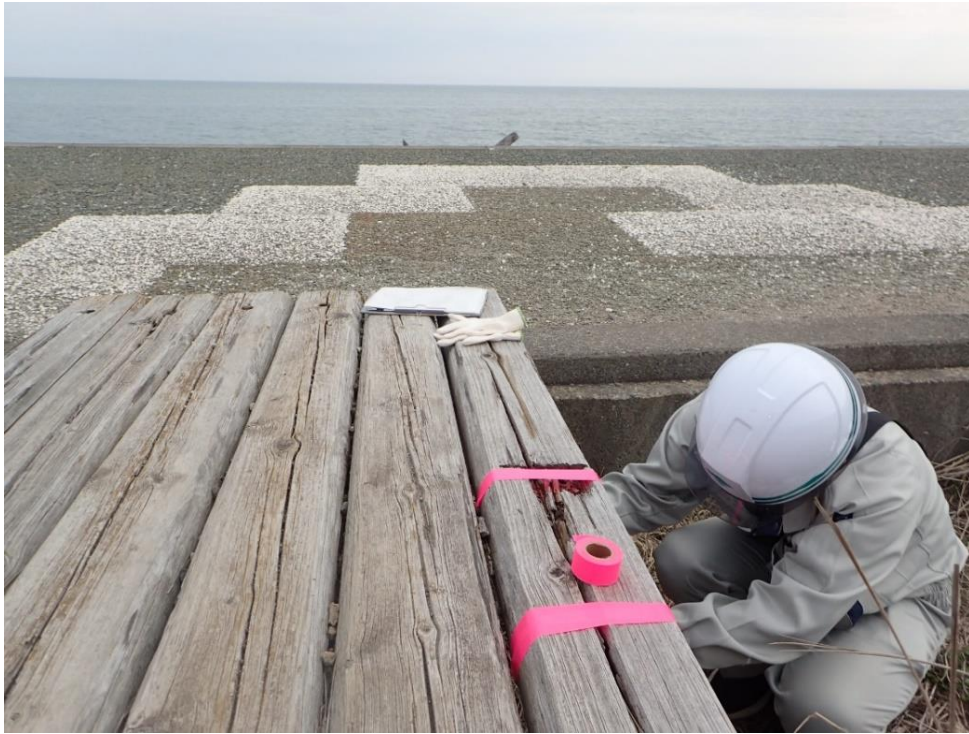
写真⑪ グレーチングの一部損傷(ピンクテープ応急措置) @胆振海岸(苫小牧有明地区)
