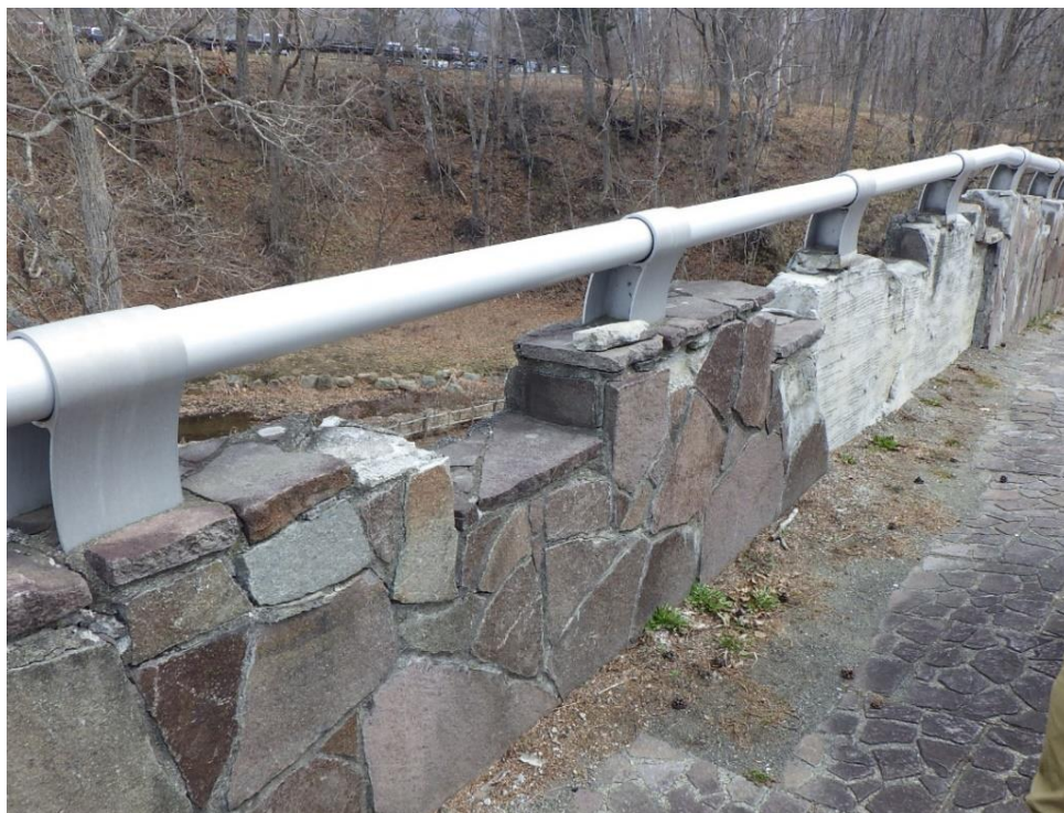
写真⑤-1 親水護岸のコンクリート壁破損(補修前) @二風谷ダム
