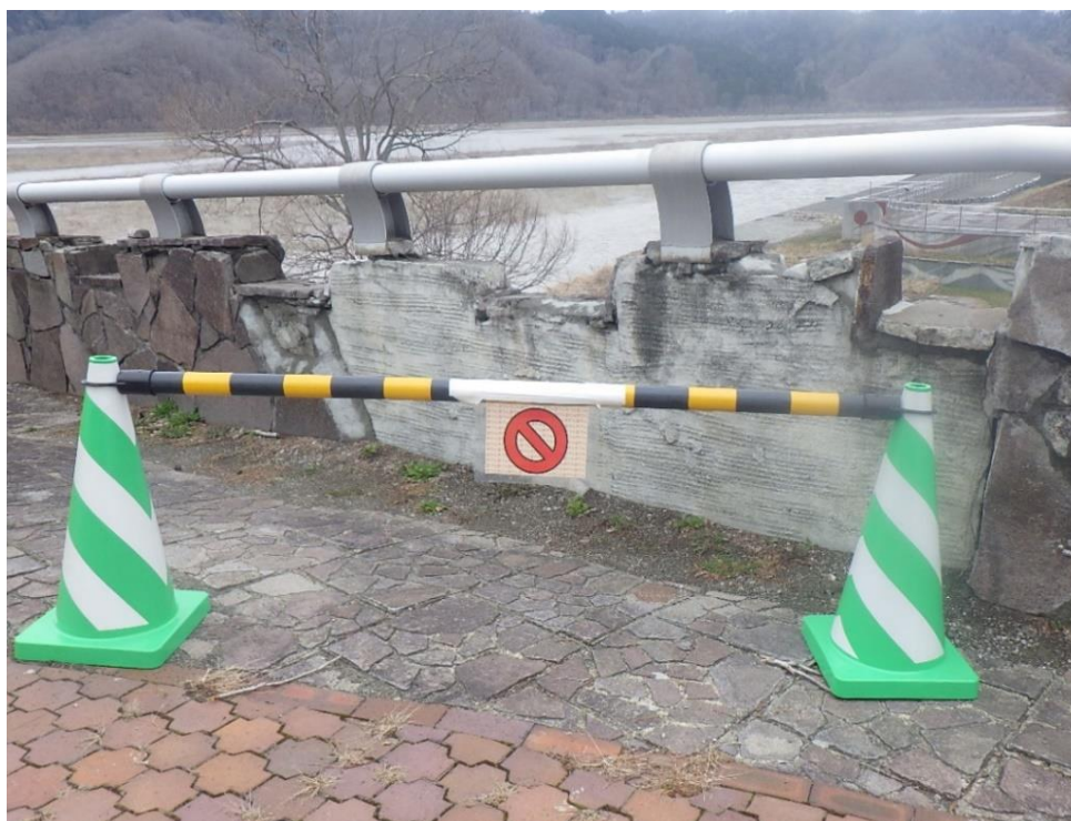
写真⑤-2 親水護岸のコンクリート壁破損(応急措置) @二風谷ダム
