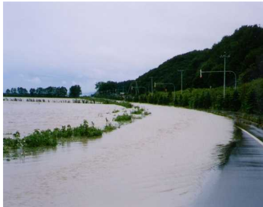
H13. 9道道米原田浦線冠水
