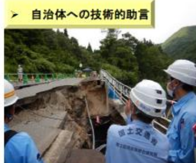
【令和4年8月の大雨】 (山形県米沢市)
