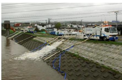
排水ポンプ車
