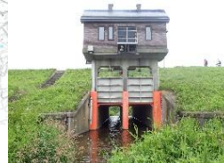
オコタン樋門
