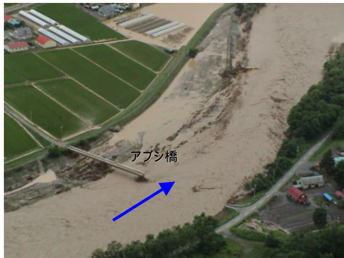
沙流川支川 額平川アブシ橋被災状況 平成15年8月10日午前撮影
