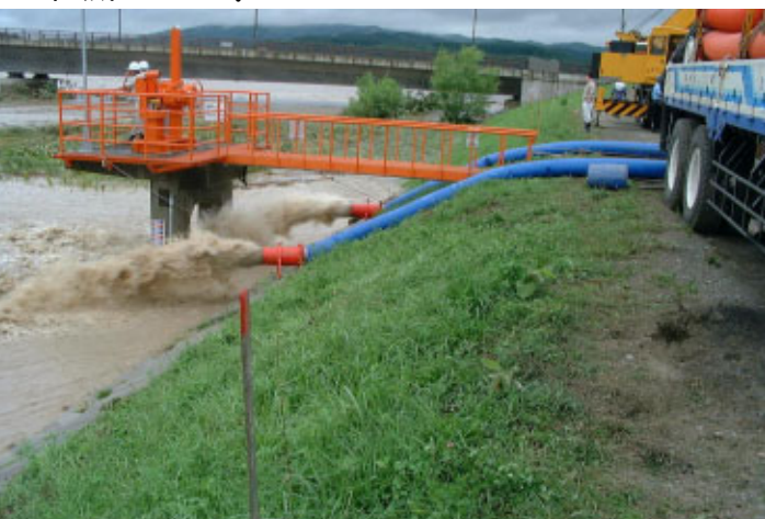
排水ポンプ車による作業状況 (穂別町 河口から約41km 付近) 平成15年8月10日午前撮影
