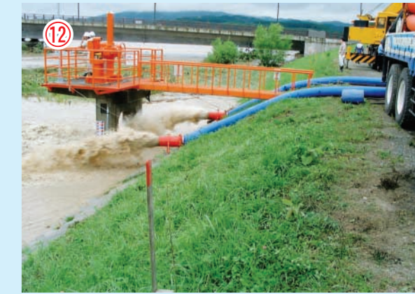
⑫ ポンプ車排水状況(穂別1号樋門) ：平成15年8月10日午前7時頃撮影
