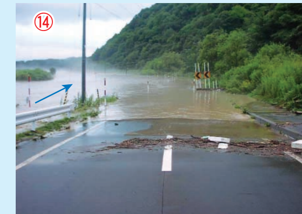
⑭ 冠水した町道穂別豊田線 ：平成15年8月10日午前7時頃撮影
