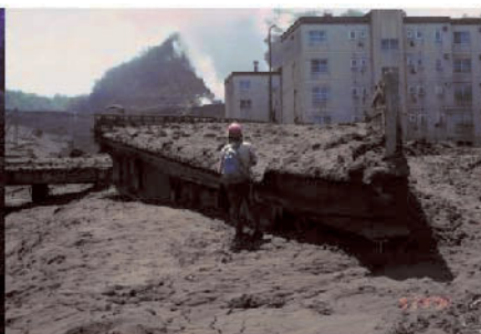
熱泥流に流された「木の実橋」
