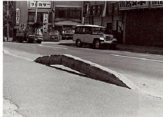
ブリッジ状に持ち上げられた道路の縁石 (北海道大学図書刊行会)
