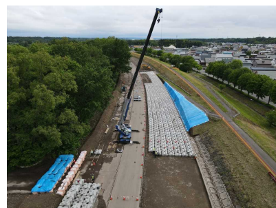
▲侵食対策の状況
