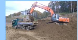
バックホウ機種を0.8m 3 級から1.4m 3 級に変更し作業効率向上を図った
