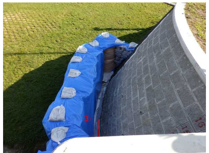
染み出し対策箇所③の状況 (7/26撮影)
