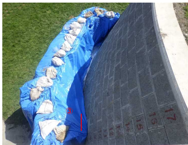
染み出し対策箇所③の状況 (8/2撮影)
