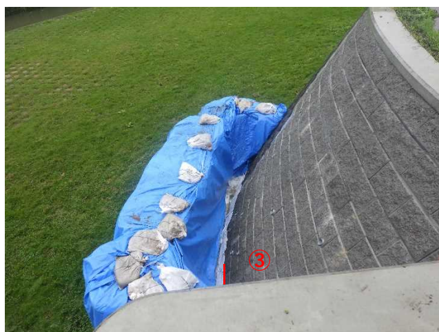
染み出し対策箇所③の状況 (8/15撮影)
