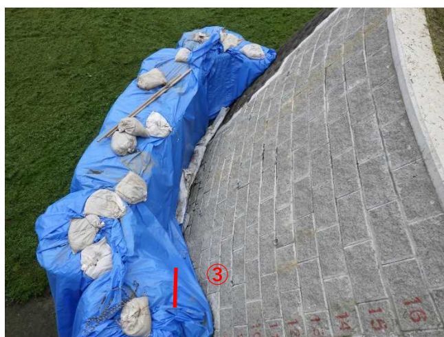
染み出し対策箇所③の状況 (8/30撮影)
