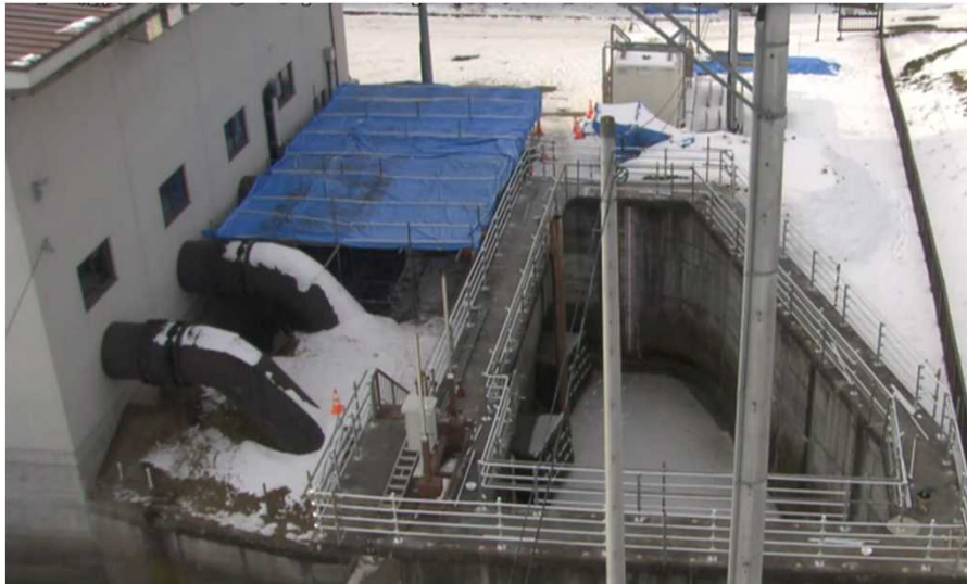
土砂撤去箇所 の 状況 (12/26撮影)
