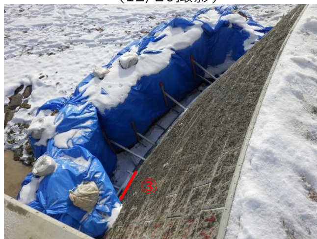
染み出し対策箇所③の状況 (12/26撮影)
