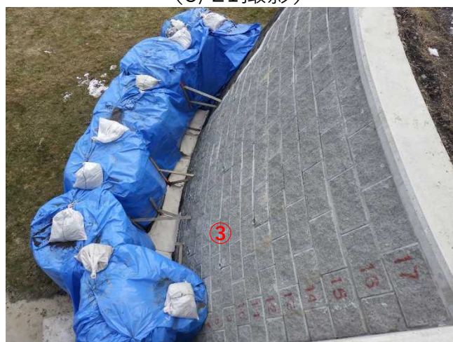
染み出し対策箇所③の状況 (3/21撮影)
