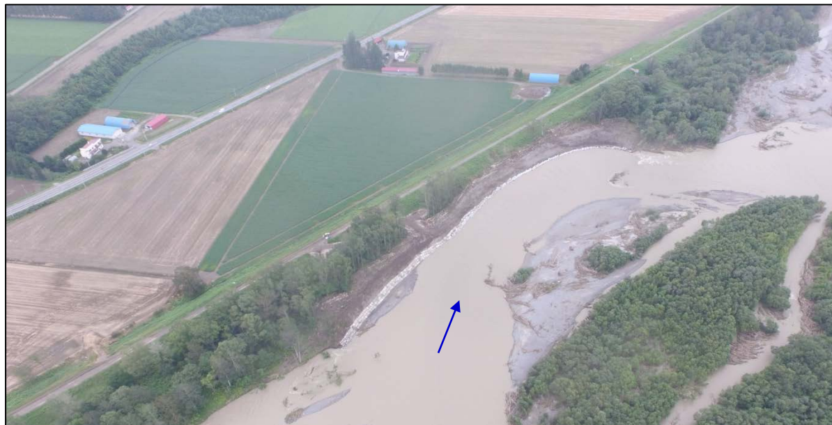
応急対策の状況(空撮)
