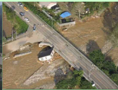
十勝川水系ペケレベツ川 河岸侵食等による家屋流出状況
