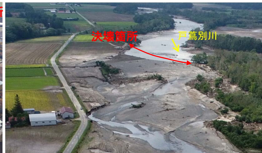
決壊箇所の状況
