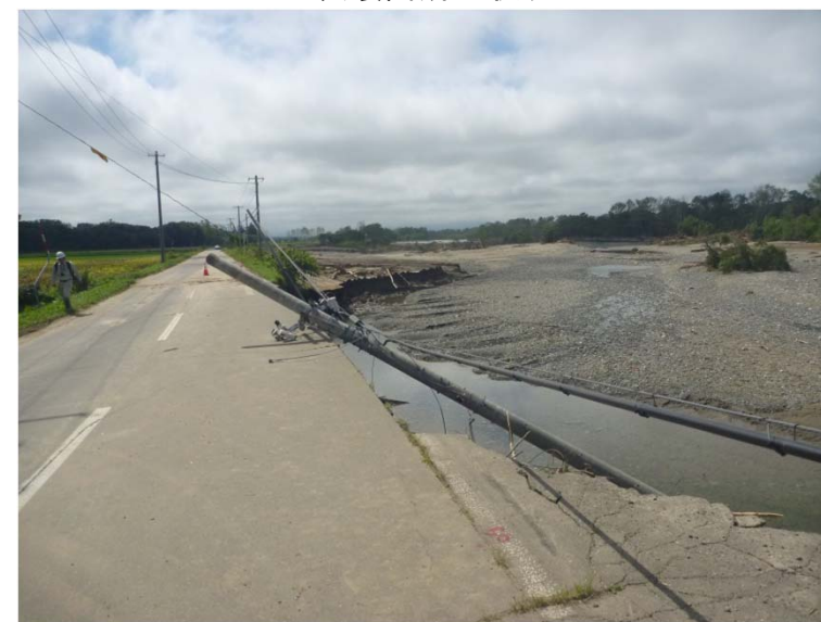
道路盛土の被災状況
