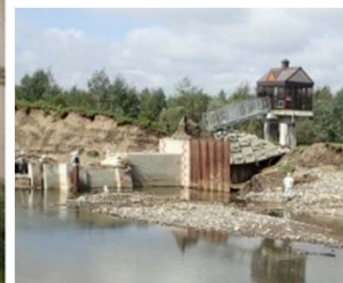
戸蔭別樋門 被災状況
