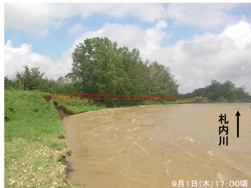
決壊箇所の状況
