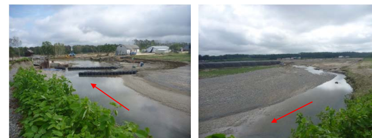
氾濫流の流下による堤内側の洗掘状況
