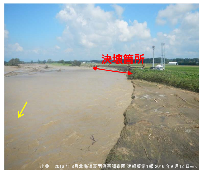
決壊箇所の状況(拡大)
