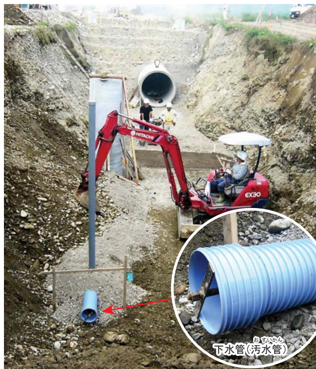
流しやトイレなどで使われ、よごれた水が流れる下水管。こうした管がつけられて、下水処理場(※3)まで行き、最後は川に流される。
