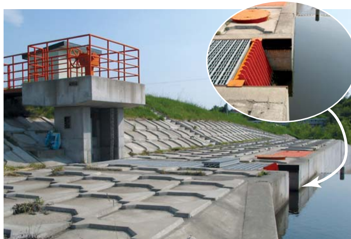
水の取り入れ口。ゴミが入らないよう、あみがある。(門のようなものは樞門 ひもん といって、堤防の下をくぐる水路。洪水のときとびらを閉める)
