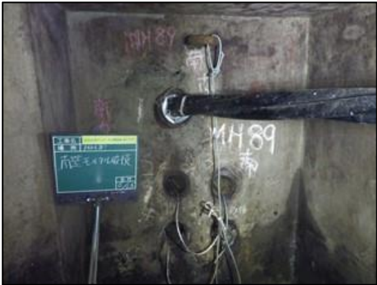
点検状況(マンホール壁面モルタル剥離確認)
