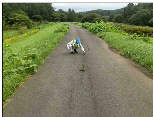
目的別巡視（天端クラック確認）
