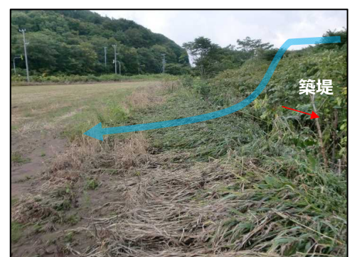
SP6450~6650 堤防溢水痕跡
