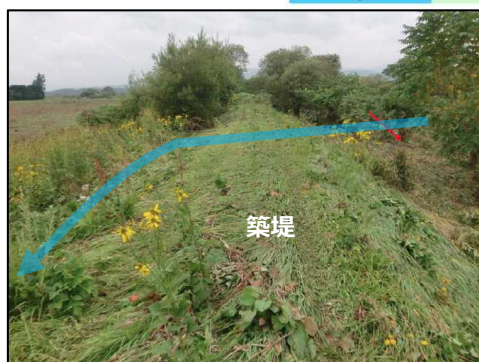
SP9000付近 堤防溢水痕跡
