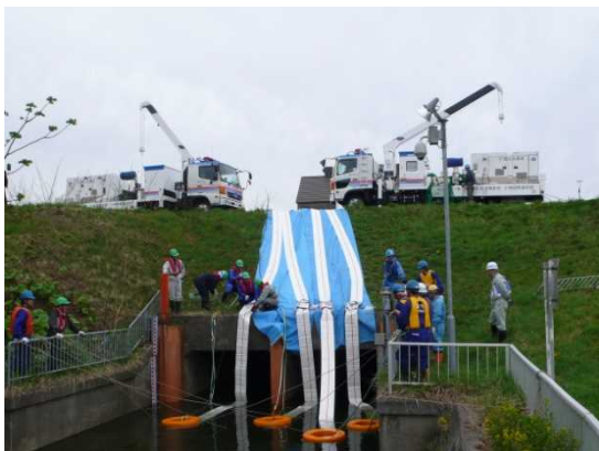
排水ポンプ車(2台)
